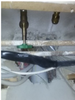
Ansicht 17: Wasser-führende Druckleitung in einem Serverraum
