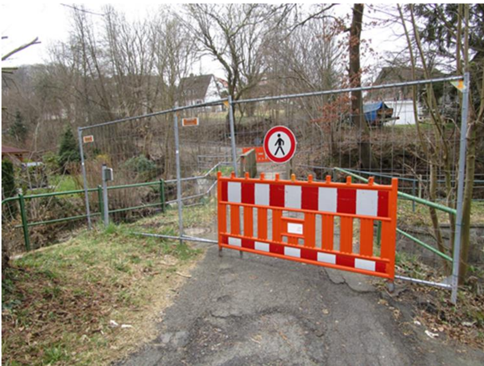
Ansicht 13: Gesperrte Brücke 75
