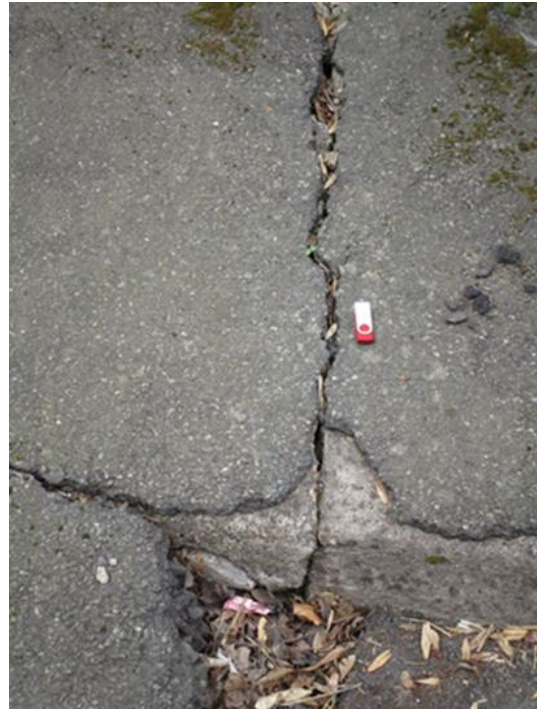
Ansicht 16: Risse in der Fahrbahndecke 89
